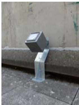
appareil LED cubique, monté sur support le long du parapet
